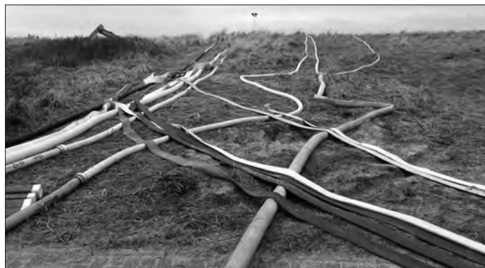
Zusätzlich zur stationären Pumpe wird von mobilen Pumpen das Wasser aus dem Moorgraben über die Düne in die Ostsee geleitet.
